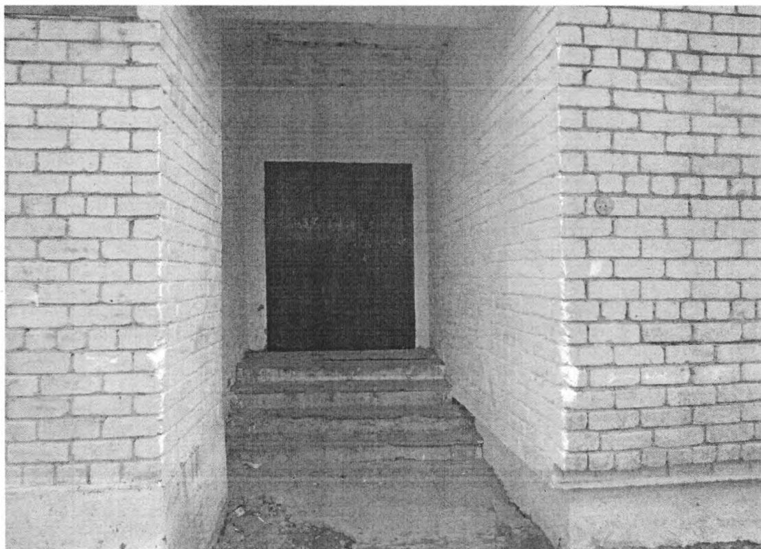
Фото 11 – Эвакуационный выход. Отсутствует доводчик и фиксаторы положений «открыто» и «закрыто», а также отсутствует контрастная маркировка
